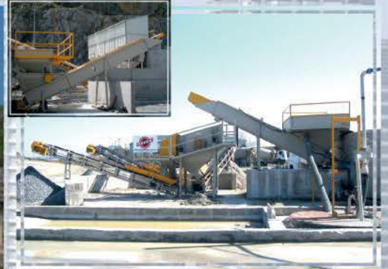
YAŞ BETON GERİ DÖNÜŞÜM TESİSİ
