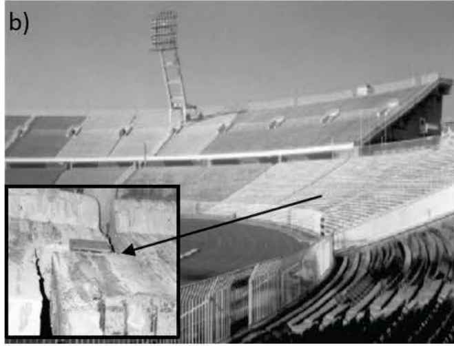
Şekil 7. Değişik sülfat etkisi oluşumları, a) Prefabrike bir giriş elemanda DEF oluşumu (ABD-Texas) b) Macaristan Ferenc Puskas Stadi yapı elemanlarında Tomasit oluşumu
