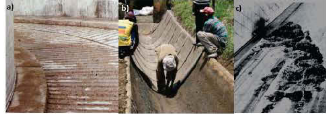
Şekil 2. Aşınma, Erozyon ve Kaviteasyon hasarları a) Otoyol rampasında aşınma b) Erozyona uğramış kanal c) Baraj dolusavağında kaviteasyon
