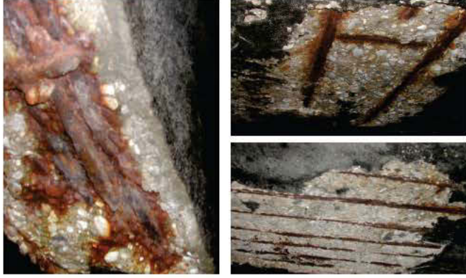
Şekil 11. Güllük iskelesinde korozyon hasarı
