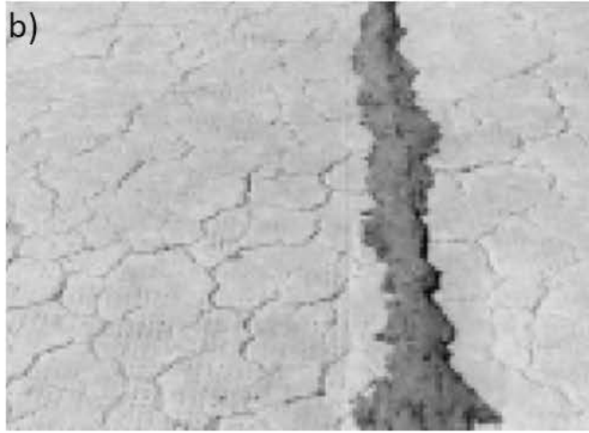
Şekil 9. ASR ve ACR hasarı a) ASR hasarına uğramış köprü ayağı (İzmir) b) Yaya yolu kaplamasında ACR çatlağı (Ontario, Kanada)
