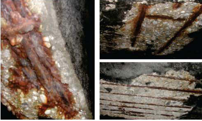
Şekil 11. Güllük iskelesinde korozyon hasarı
