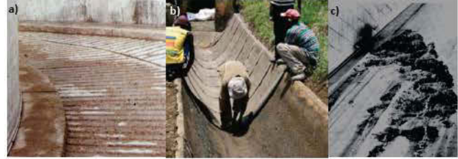
Şekil 2. Aşınma, Erozyon ve Kavitasyon hasarları
