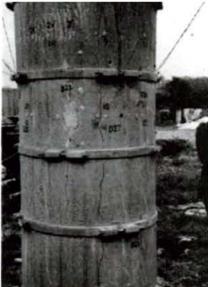
Şekil 4. Bir karayolu köprüsü kolonunda oluşan ASR çatlakları [23,40]
