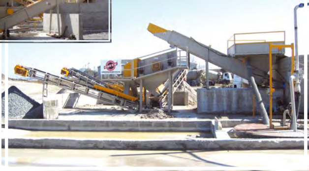
YAŞ BETON GERİ DÖNÜŞÜM TESİSİ
