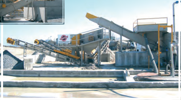
YAŞ BETON GERİ DÖNÜŞÜM TESİSİ
