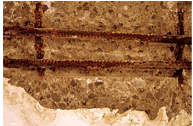
Fotoğraf 1: Korozyona uğrayan donatı çeliği ve dökülen pas payı tabakası
