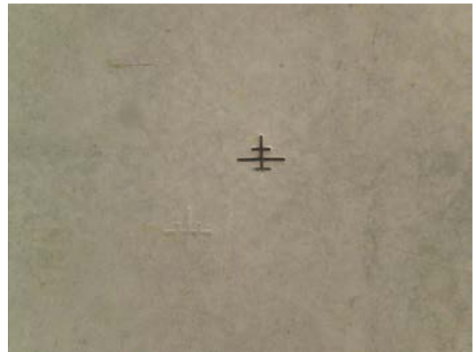
Fotoğraf 4: Beton kalıp demontajı sonrası plastik pas payı elemanının beton yüzeyindeki görünüşü
