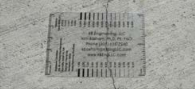
Fotoğraf 1. Bir çatlak karşılaştırma kartı kullanarak çatlak genişlikleri ölçülebilir.
