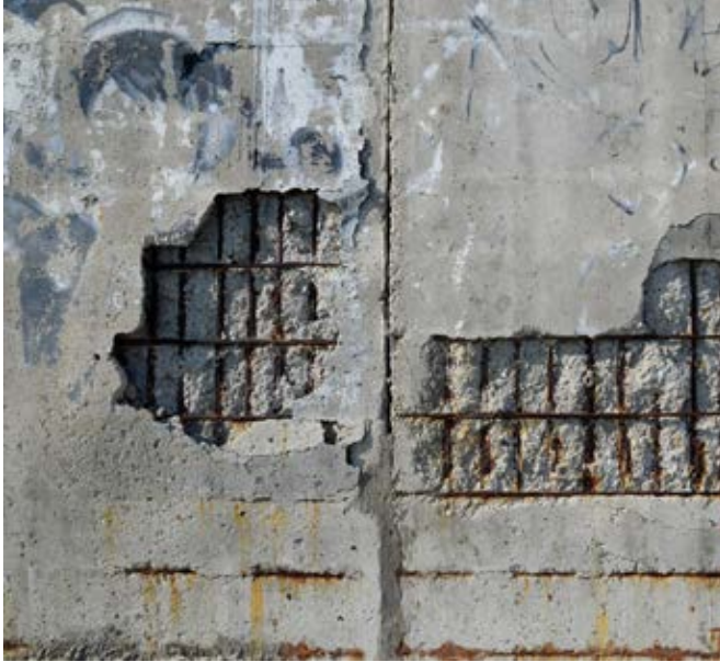
Betonarme donatısı açıkta beton perde
