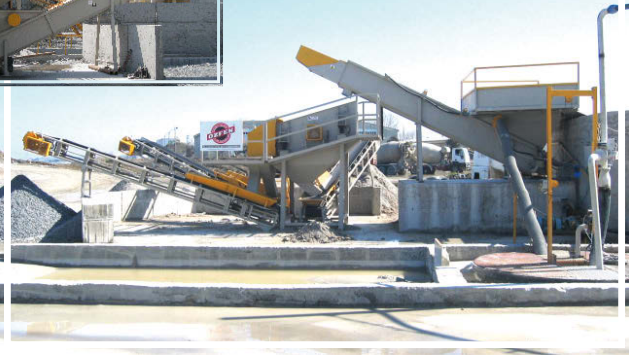
YAŞ BETON GERİ DÖNÜŞÜM TESİSİ
