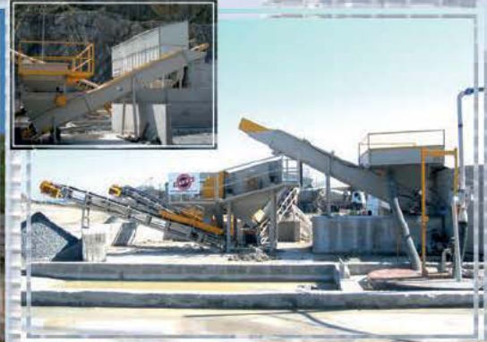
YAŞ BETON GERİ DÖNÜŞÜM TESİSİ
