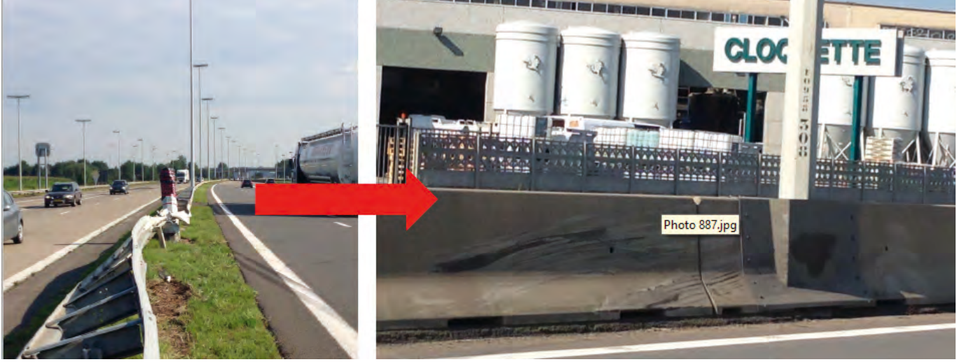
Şekil 7: Belçika'da hafif kazalar sonrası beton bariyer ve çelik bariyerlerdeki hasar
