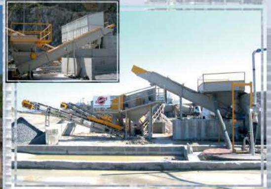
YAŞ BETON GERİ DÖNÜŞÜM TESİSİ
