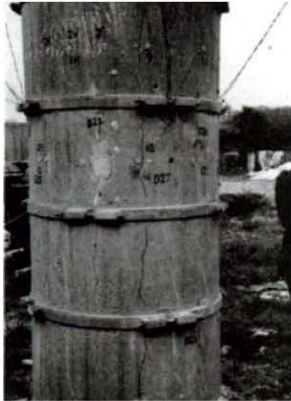
Şekil 4. Bir karayolu köprüsü kolonunda oluşan ASR çatlakları [23,40]
