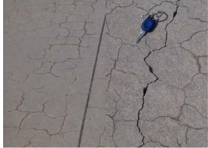
Şekil 5. İzmir Adnan Menderes Havalimanı pist ve taksi yolu betonunda oluşan ASR çatlakları [40]
