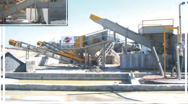
YAŞ BETON GERİ DÖNÜŞÜM TESİSİ
