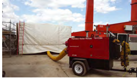
Resim 2: Isıtıcı ile ortam sıcaklığının kontrol edilmesi[7]
