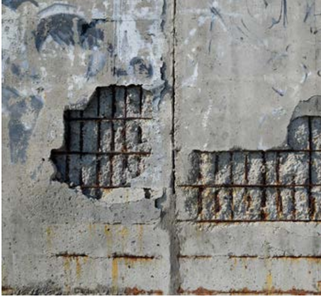
Betonarme donatısı açıkta beton perde
