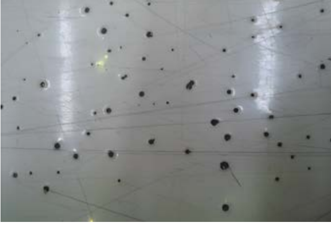
Şekil 7: Epoksi kaplanmış zemin betonu içinde oluşan su buharının epoksi kaplamada oluşturduğu çoklu kabarcıklar
