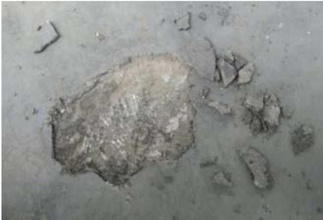
Şekil 3: Kuru serpme türü bir yüzey sertleştirici ile taze hâldeki betonun kaynaştırılmaması ve yetersiz kenetlenme nedeniyle soyulmanın oluşması
